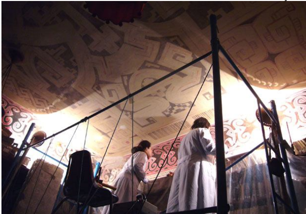
Vista de restauración de pinturas del cielorraso
