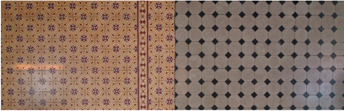
Figura 4: Fotografía de la iglesia parroquial de Rosario en su estado actual: a la izquierda, el pavimento de la iglesia del siglo XX; a la derecha, el pavimento de la iglesia del siglo XIX (solamente en la nave este).
